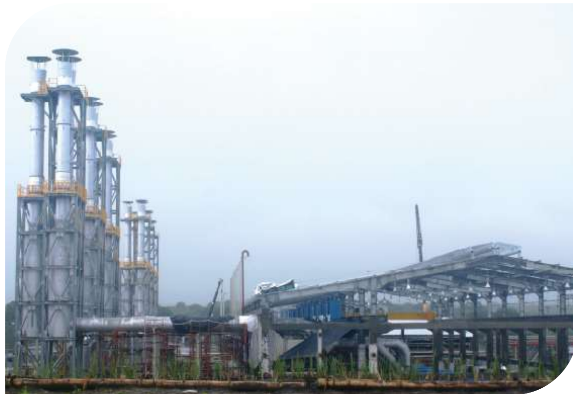
● JARAMIJÓ Thermal Power Plant.
