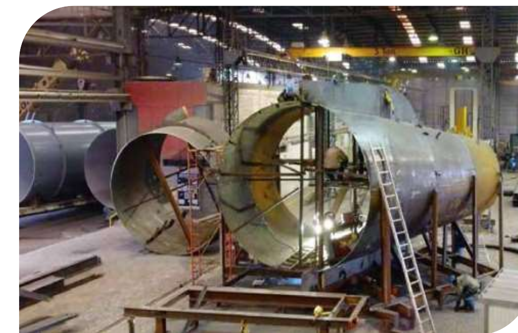
● Tubería y Bifurcador Hidroeléctrica Toachi Pilatón
