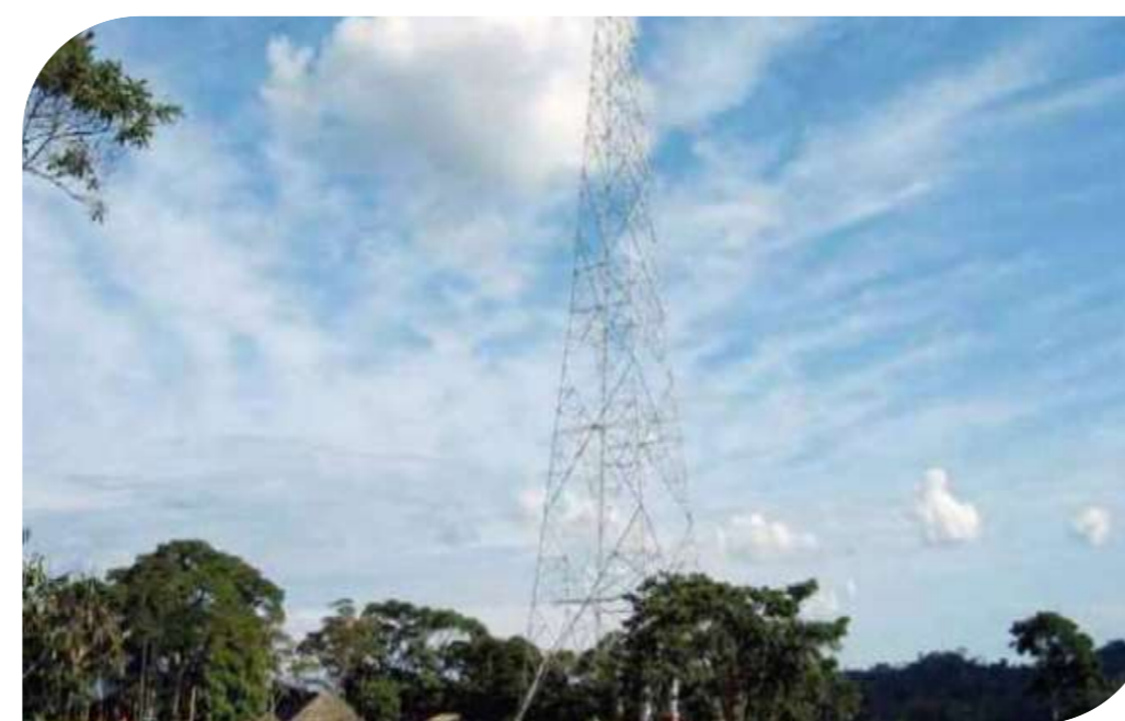
● Línea de Transmisión Cruce del Río Napo 69kV.
