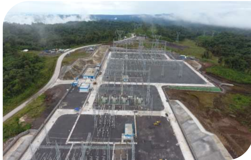
● Subestación San Rafael 500 kV. y 230 kV.
