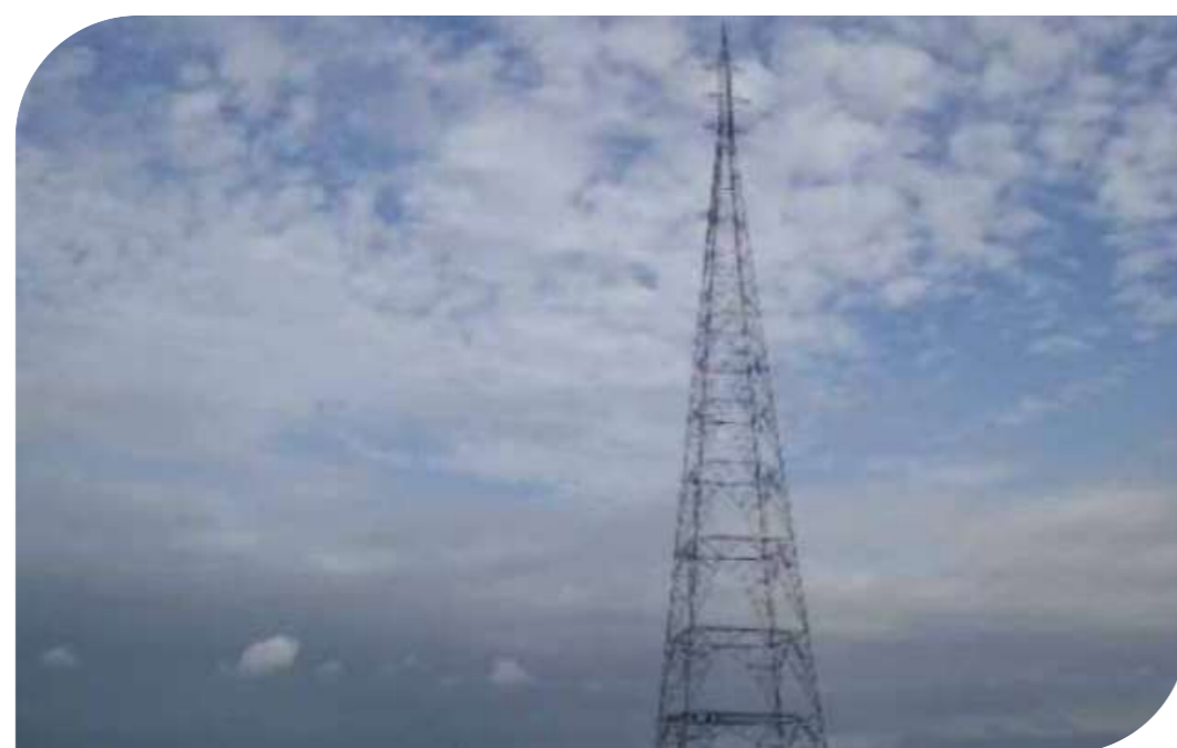
● Línea de Transmisión Milagro – Las Esclusas 230kV.
