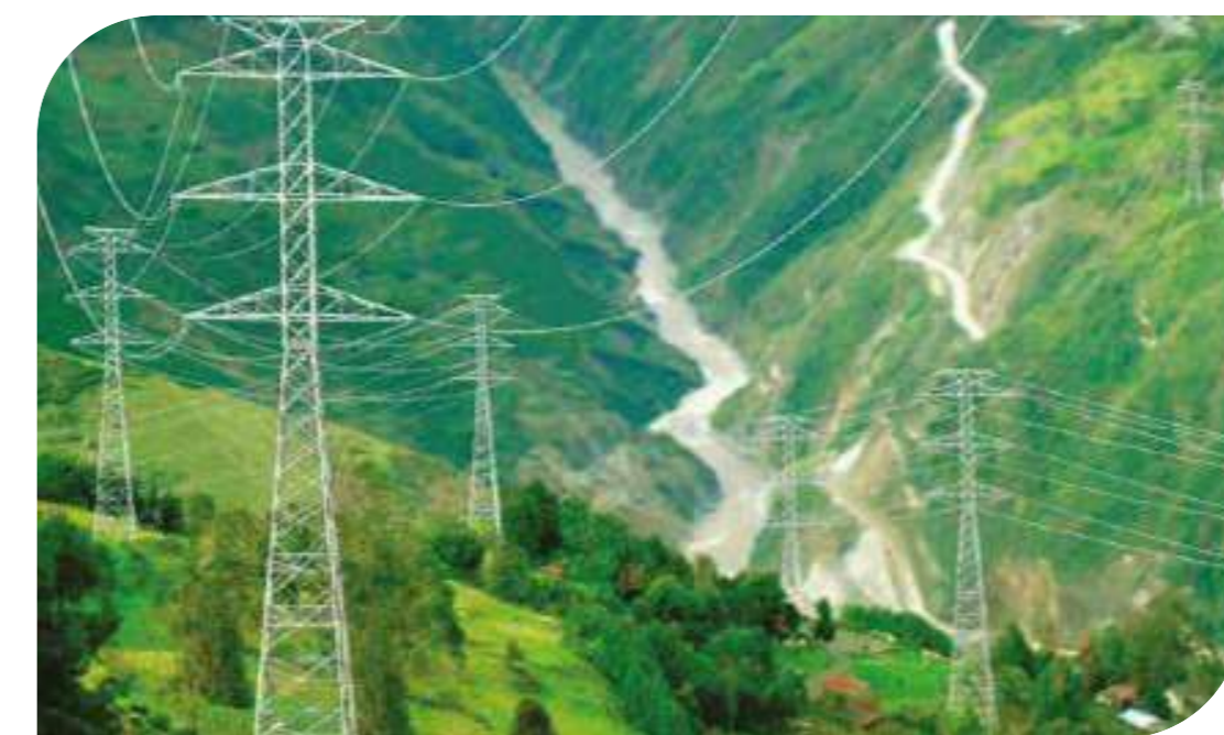
● Línea de Transmisión Mazar- Shoray 220KV
