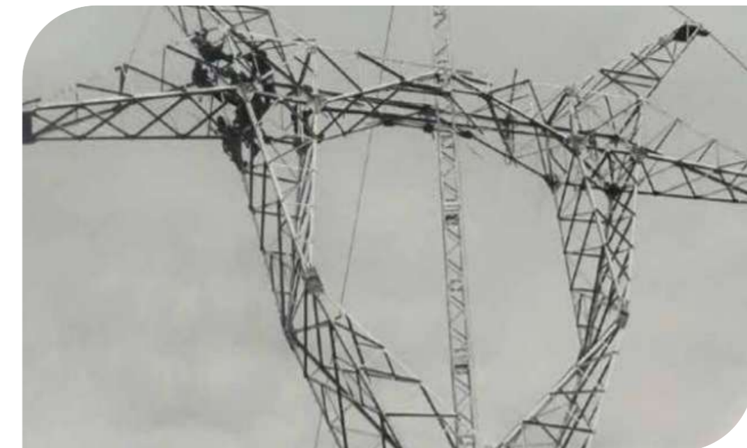
● Línea de Transmisión San Rafael – Subestación el Inga 500kV.
