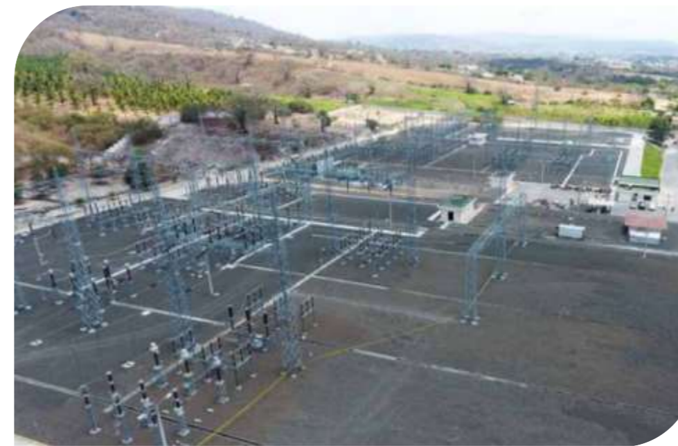
● Subestación San Gregorio 230 kV. y 69 kV.
