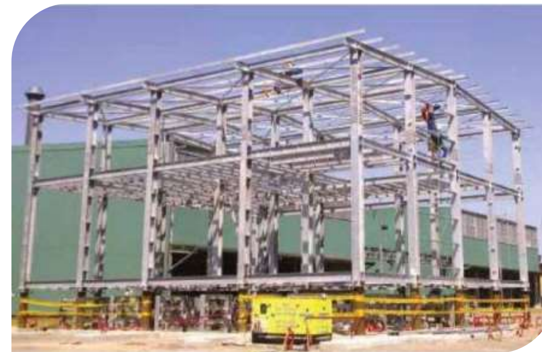
● Edificio Eléctrico SHINA OGE
