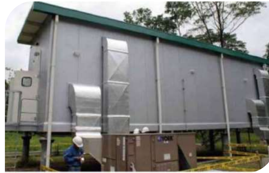
● Edificio Eléctrico Frontera
