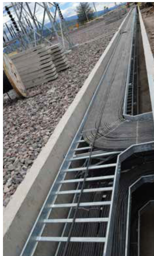
Bandejas PortaCables Subestación El Inga.
